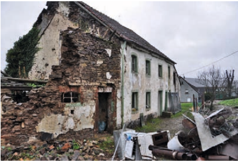
Ruinöses und leerstehendes Wohngebäude Foto: Fachgebiet Stadtumbau + Ortserneuerung
