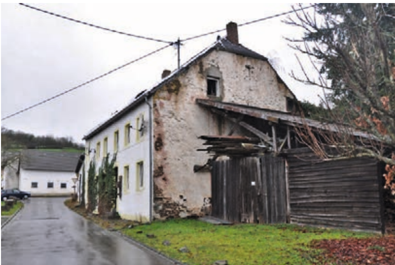
Sanierungsbedürftiges Wohngebäude in Niederpierscheid Foto: Fachgebiet Stadtumbau + Ortserneuerung
