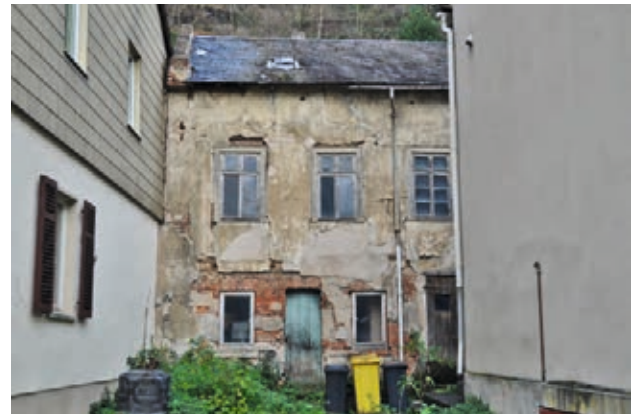
Leerstehendes Objekt in schlechtem baulichen Zustand unmittelbar an die Eisenbahnstrecke angrenzend Foto: Fachgebiet Stadtumbau + Ortserneuerung
